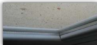
Cerramiento con doble acristalamiento
