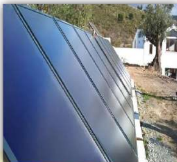
Captadores de Instalación Solar Térmica
