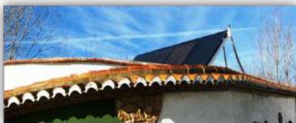
Instalación de ACS con Energía Solar Térmica
