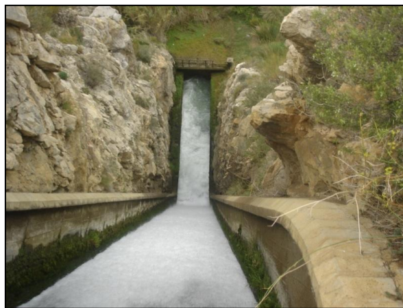
Figura 1: Salto de la central Partidor de Cañizares.
