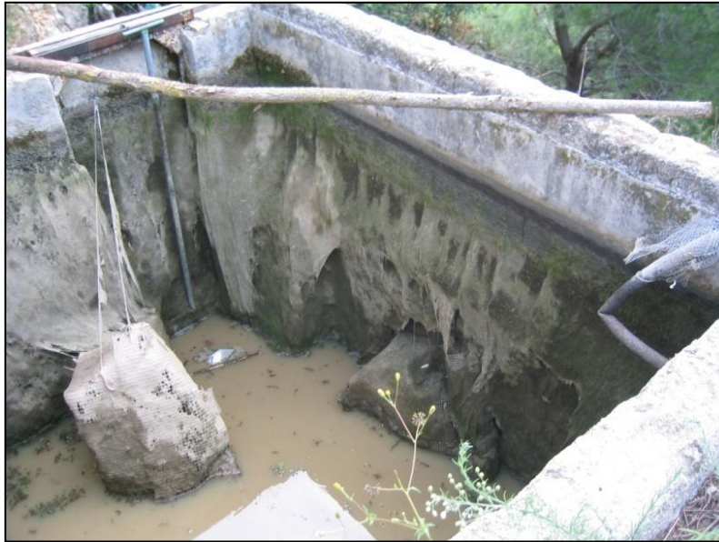
Figura 5: Cámara de carga de la central Guajar Fondón
