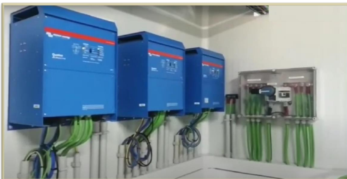
Image 3: Inverters and voltage and voltage regulators Fuente: Aportada por la empresa
